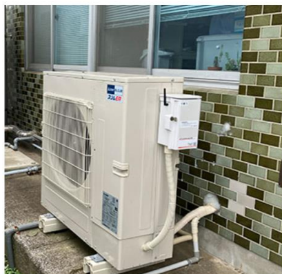
空調制御機能器を取り付けた空調室外機
