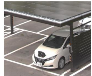
ソーラーカーポートに設置した充放電器から充電を行う公用車 EV
