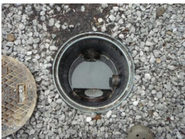
設置された防油柵
