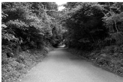
道路を覆いつくす支障木。カーブミラー、標識も見えないところも安全対策が急がれる。
