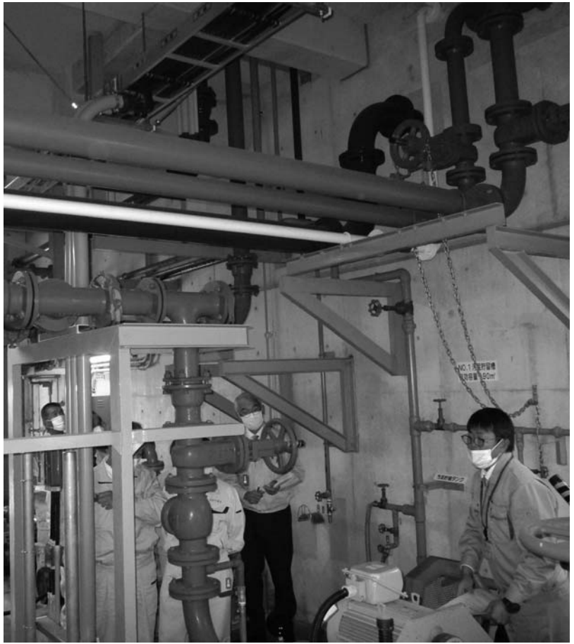
【現地調査：国富浄化センター 機械装置更新工事】
