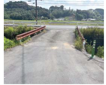
小園橋は、狭くて離合できないため、対策が必要。
